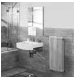
Vorher: Alter Heizkörper
